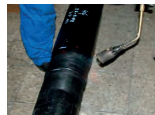
8. Precaentar el área de los extremos del manguito aprox. 70°C.
